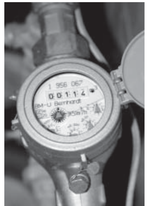
Ein regelmäßiger Blick auf den Wasserzähler erspart bei Leitungsdefekten unnötige Mehrkosten.
